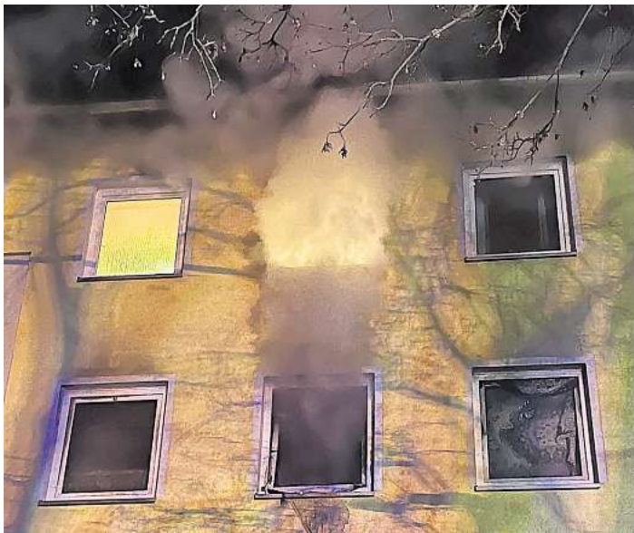
Im vierten Geschoss dieses Mehrfamilienhauses in der Friedrich-Ebert-Straße brannte es in der Nacht zu Samstag. Die Feuerwehr rettete zwei Menschen aus der darüberliegenden Dachgeschosswohnung. FOTO: FEUERWEHR MARBURG
