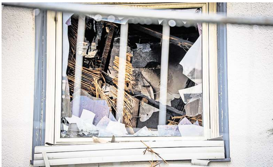
Das Haus von Familie M. ist nach dem Brand einsturzgefährdet. Stadt und Nachbarschaft bemühen sich, damit die Familie schnell wieder auf die Beine kommt.
